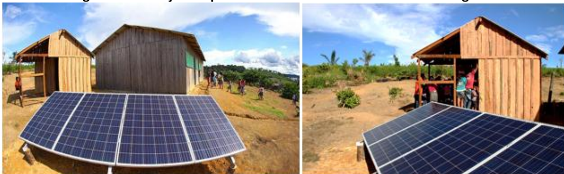
Figura 6: Utilização de placas solares nas escolas em aldeias indígenas
