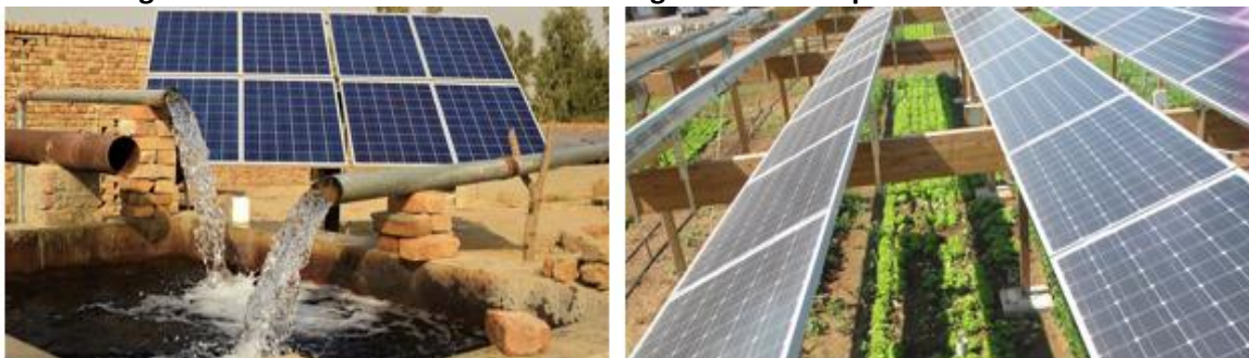
Figura 3: Sistema de bombeamento de água através de placas fotovoltaicas
