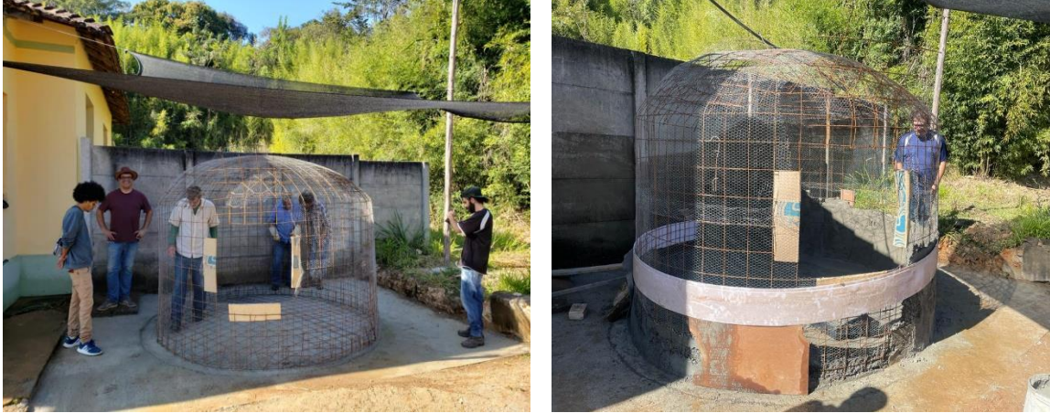
Figura 4 – Cisterna de ferrocimento em processo de construção no Centro de Vivência em Saneamento Rural
