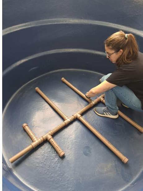
Figura 3: Dreno do pré-filtro
