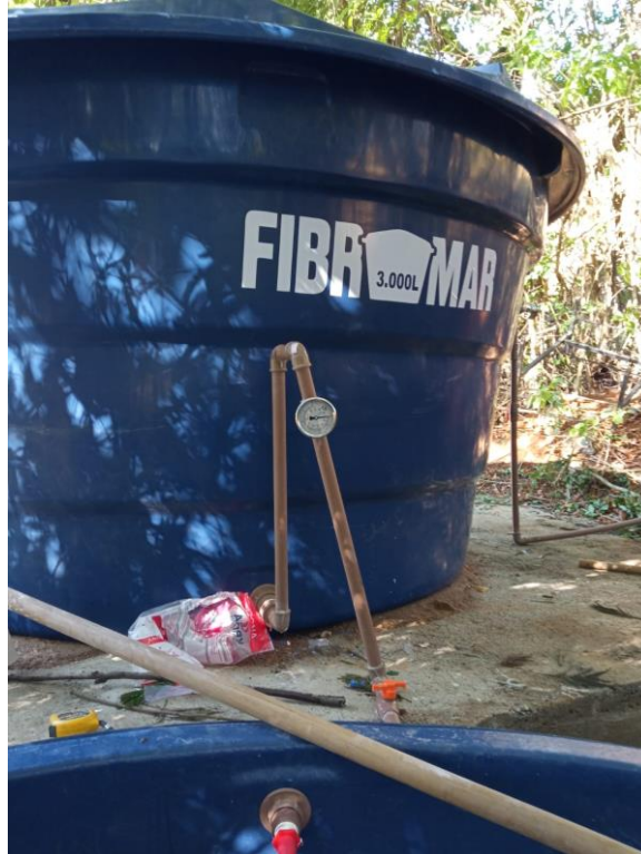
Figura 10: Sifão após caixa d'água
